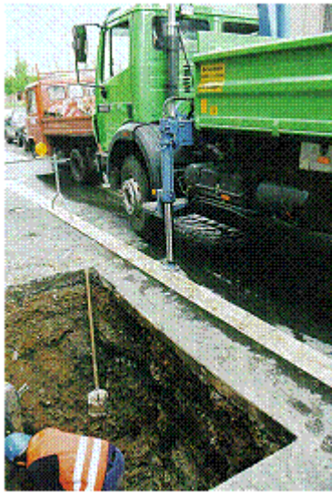
Abb. 167: Sicherheitsabstand zur Baugrube zu gering
