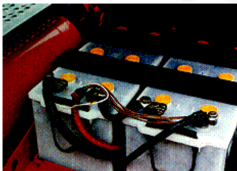
Abb. 41: Fehlende Polabdeckungen an Batterien
