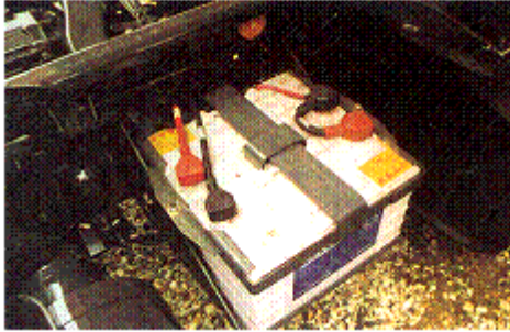
Abb. 42: Berührungsschutz durch Polabdeckungen
