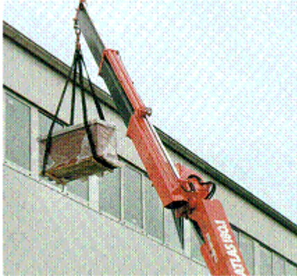
Abb. 242: Ein Zusammenrutschen der Anschlagmittel ist verhindert
