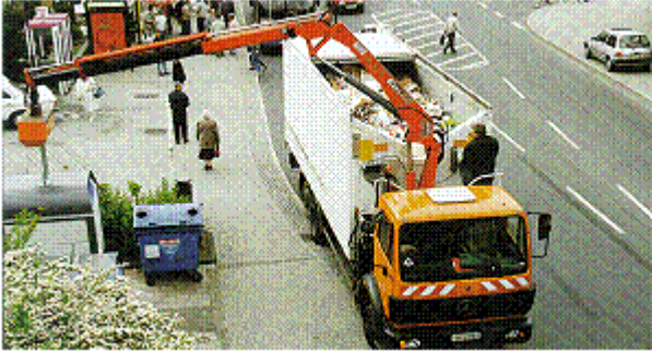
Abb. 156: Unzulässig: Kran nicht abgestützt
