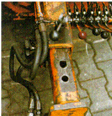
Abb. 127: Aufgeweitete Verriegelungsbohrung am Abstützträger
