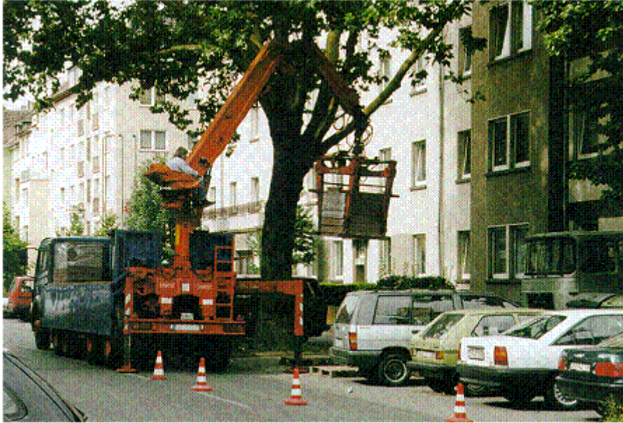
Abb. 135: Unfallgefahr: Kranbetrieb mit nur lastseitig ausgefahrenem Abstützträger
