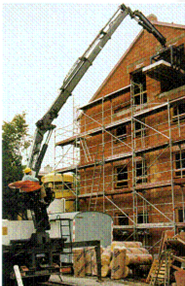
Abb. 191: Unzulässiger Einsatz eines Steingreifers im nichtbodennahen Bereich
